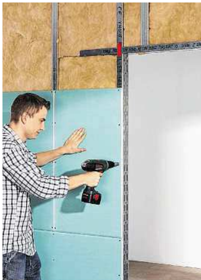
Steht das Gerüst und ist die Dämmung eingesetzt, kann der Heimwerker die Platten auf die Trockenbau-Wand einfach und schnell aufschrauben. FOTO: DIY-ACADEMY/KNAUF BAUPRODUKTE
